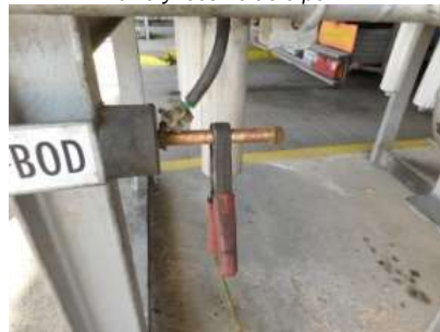
töltő kút földelő pont
