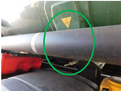
tartálykocsi földelő pont
